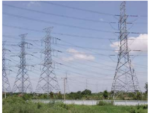
เสาไฟฟ้า
